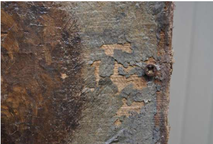
Figura 6 Particolare che mostra lo stato delle superfici con cadute di pellicola pittorica
